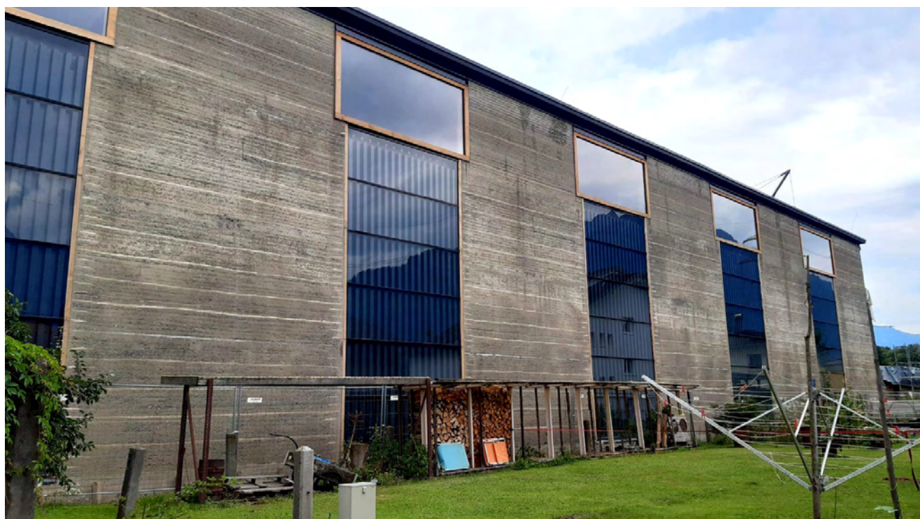
Südfassade mit Solarkollektoren
